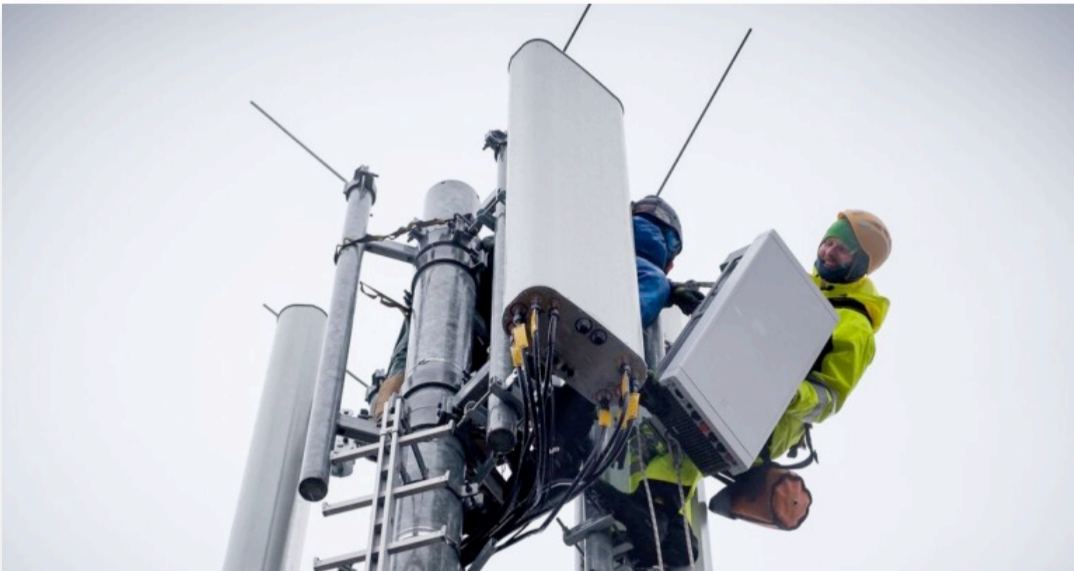
Telekom-5G-Netzaufbau. Bild: Telekom
